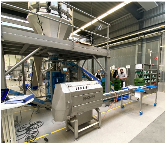
Die Produktionslinie umfasst neben den Waschmaschinen auch eine GS 10-2 Bandschneidemaschine sowie ein Verpackungssystem.
